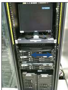
F MCC - serveur
